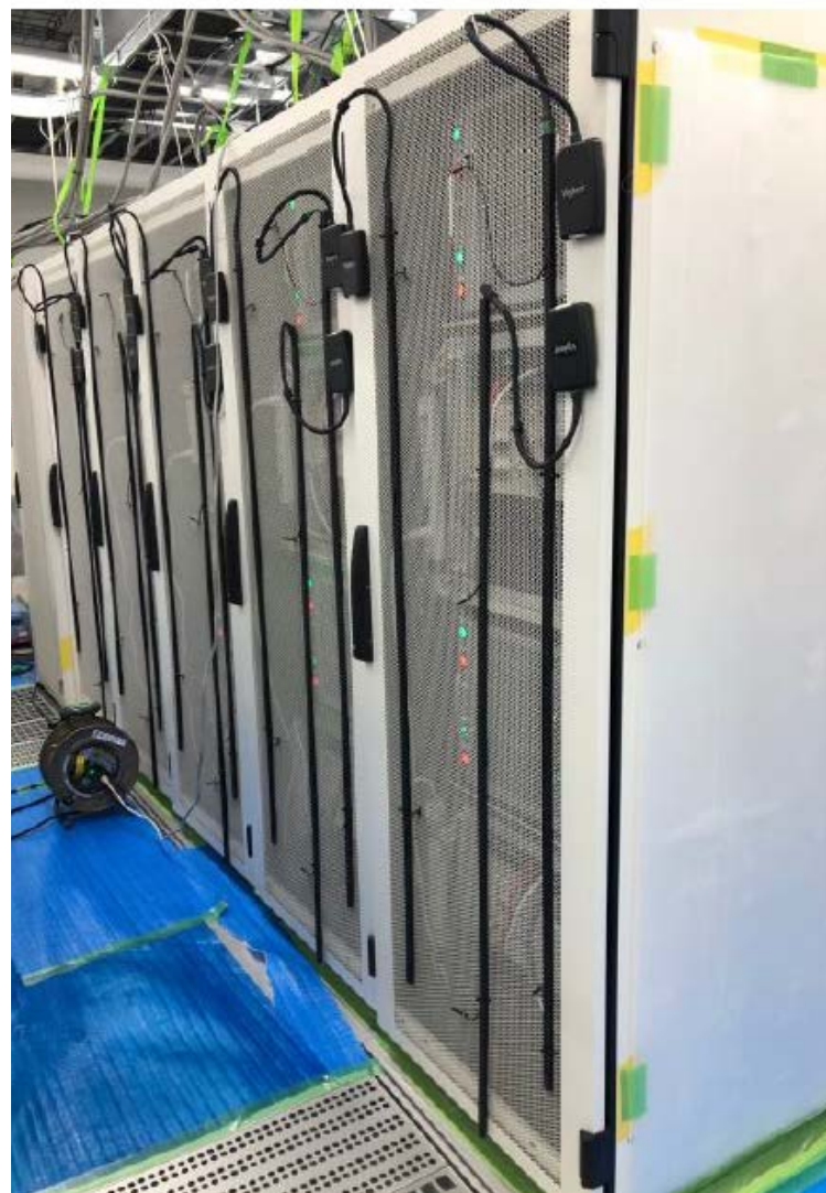
試験室写真（コールドアイル）
